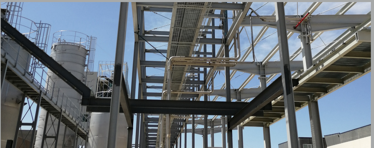
Instalaciones y mantenimiento
